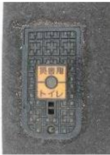
防災マンホール
